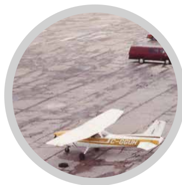
Etat de la piste avant réparation en 1992 - Sécurité des usagers compromise
