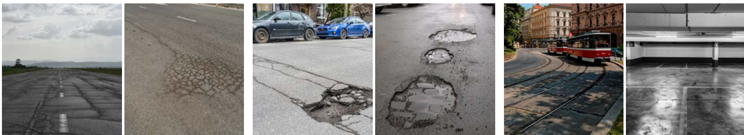
Příklad trhlin u velkoplošných oprav
