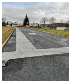
Image 12: Fissures longitudinales et transversales
