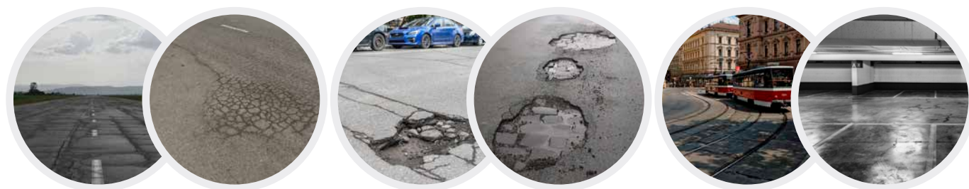
Exemples de fissures pour réparations de grandes surfaces
