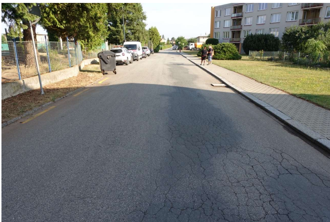
OBRÁZEK Č. 10 – PORUCHA PŘED OPRAVOU
