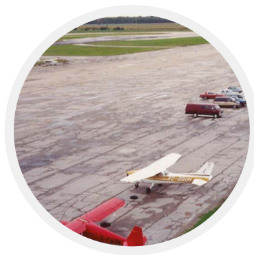
Stav povrchu před opravou v roce 1992 - ohrožení bezpečnosti
