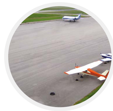
Stav vyztuženého povrchu po dvaceti letech (fotografie z května 2012)
